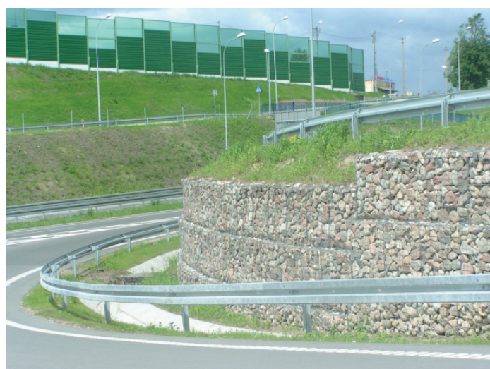
Ryc. 7.12 Przykład zastosowania gabionów jako muru oporowego na DK8 Źródło: http://drogi.innovator.net.pl
